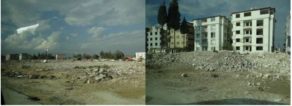
Şekil 3 Hasar alan binaların kontrollü yıkımından sonra aynı araziye serilmiş enkaz atıkları
